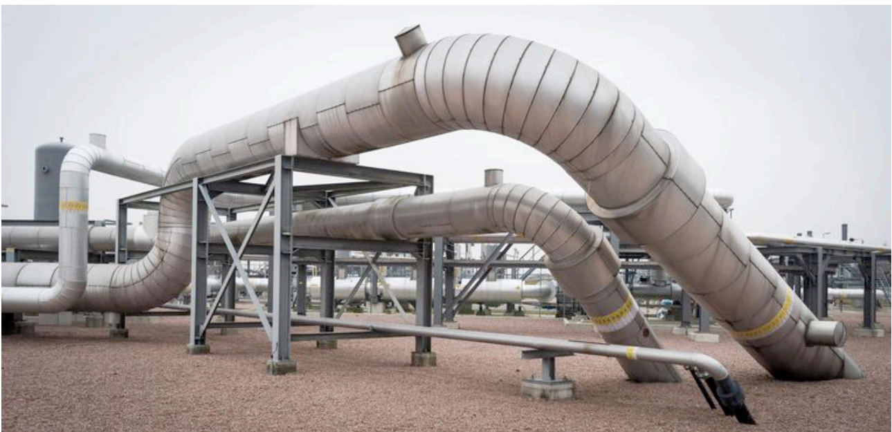
De gasopslag van de Nederlandse Aardolie Maatschappij (NAM) in Langelo. Op dit punt komt het aardgas het opslagdepot in Norg binnen
